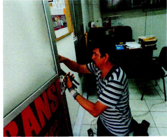
Reparación de la cerradura de la puerta de aluminio de la oficina de la Unidad de Comunicación Social.
