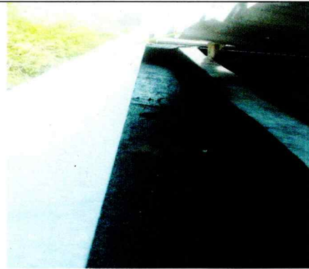
Fabricación del canal de lámina del drenaje de agua del techado del edificio que se ubica en periférico.
