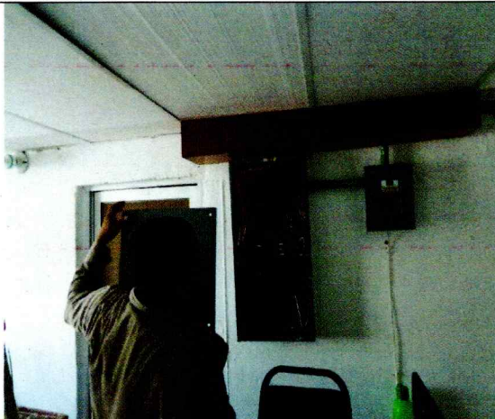
Instalación eléctrica en la oficina nueva del OSFE.
