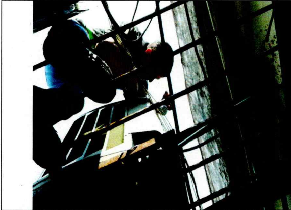
Reparación del aire acondicionado tipo mini split de la sala de sesiones (cambio del capacitor del motor ventilador de la unidad condensadora).
